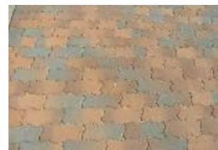
浸透施設(インターロッキング)
