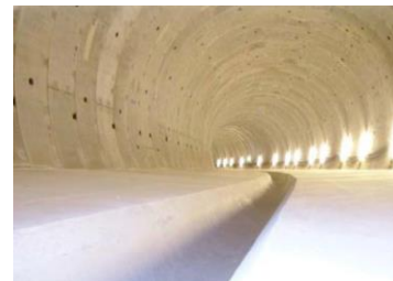
下水道施設(雨水貯留管)
