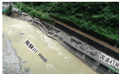
国道41号 道路崩壊 (岐阜県下呂市)
