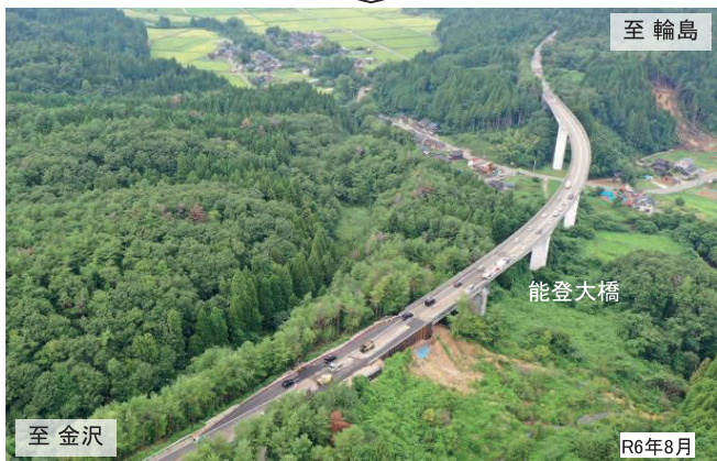
写真:能登大橋付近 盛土崩落箇所
