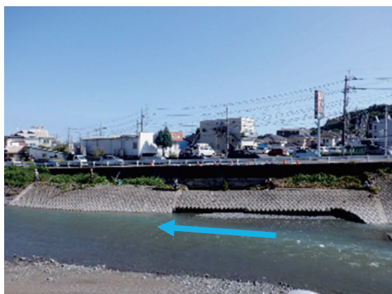
写真-3 金目川被災箇所
