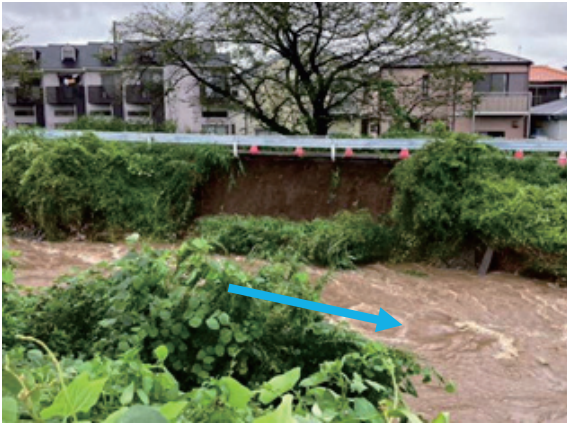
写真-4 荻野川被災箇所
