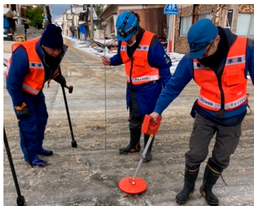
漏水調査 (令和 6 年能登半島地震)
